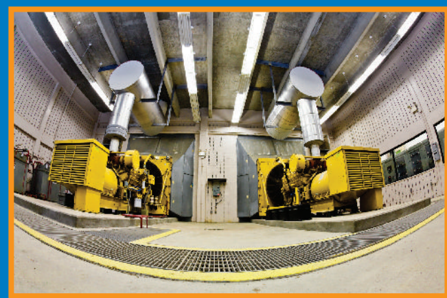
Изготовители комплексного оборудования
